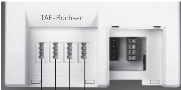
TK-Anlage mit geöffnetem Anschlussfeld
